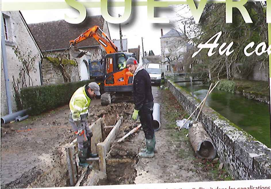
Travaux rue des Moulins en février : la rivière s'infiltrait dans les canalisations.
