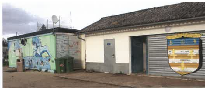
Les vestiaires du foot ont bien besoin d'être rénovés.
